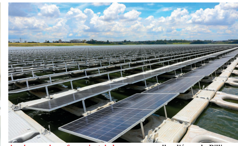
As placas solares foram instaladas em um espelho d'água da Billings na Zona Sul de SP
