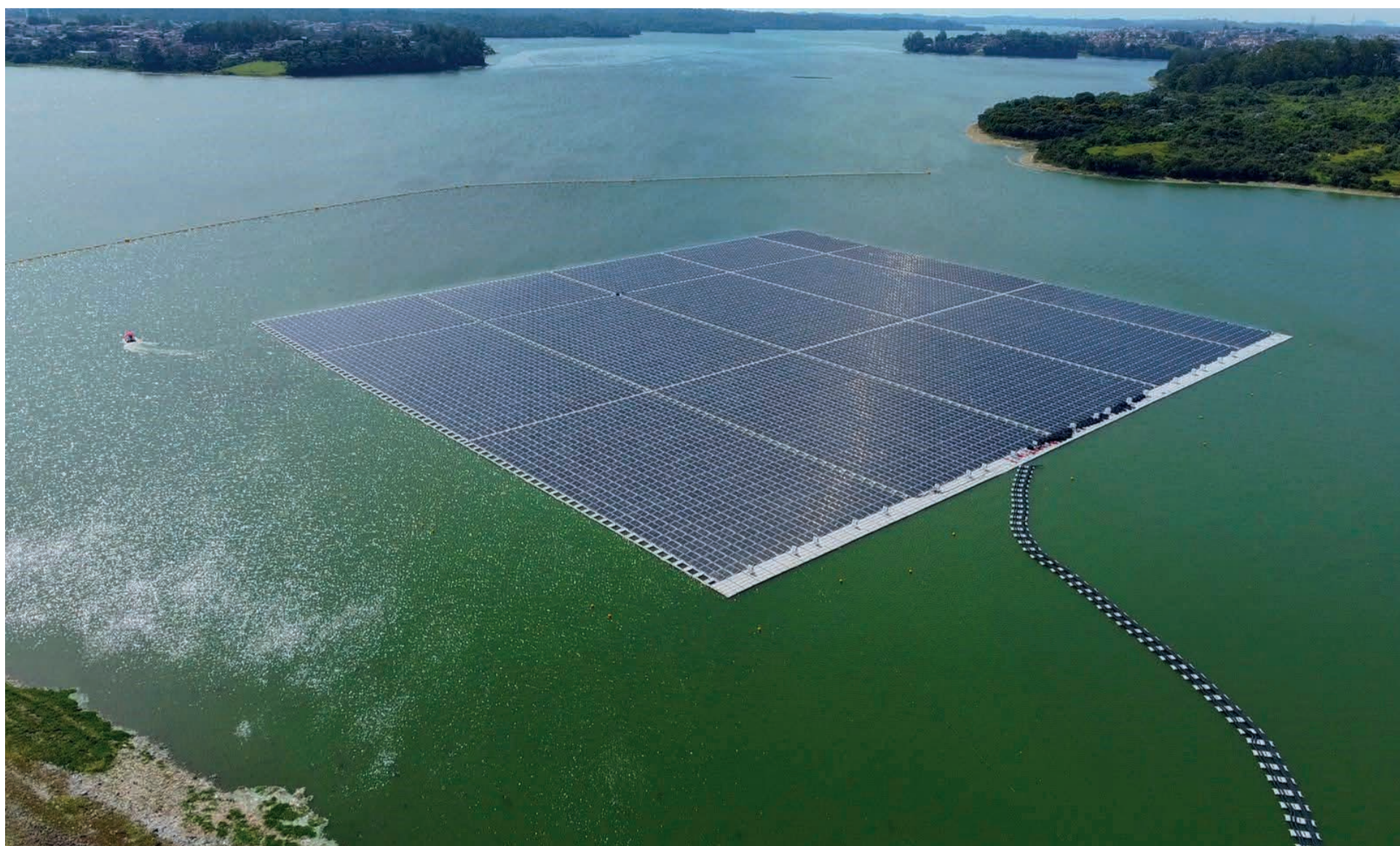
A Usina Solar Fotovoltaica Flutuante Araucária foi instalada na represa Billings, em São Paulo
